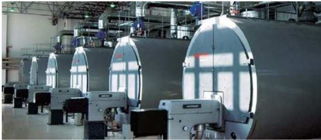
Figuur 10: Gasketels voor opwekking op wijkniveau
